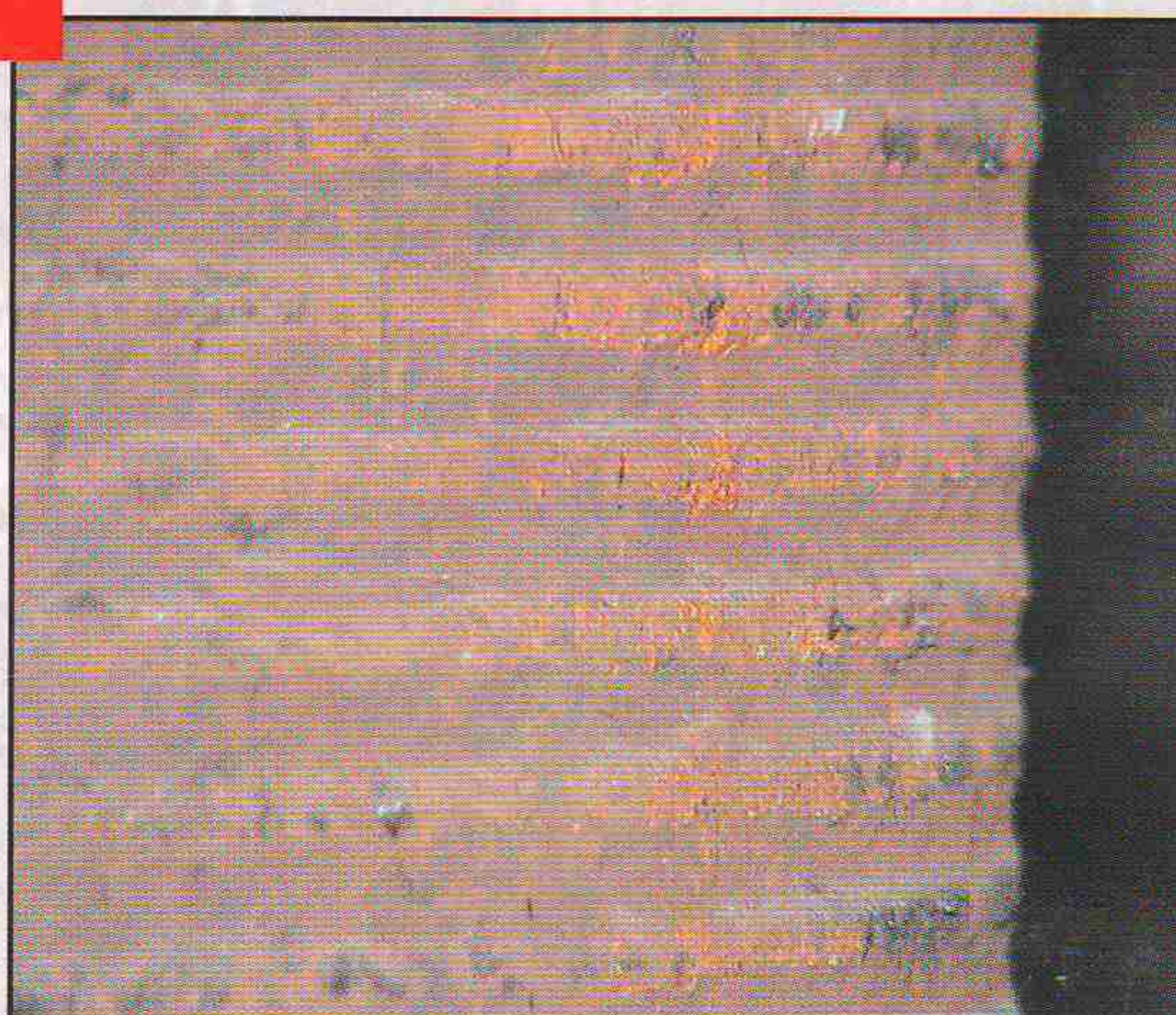
Полностью корродированная внутренняя резьба колонны под архитравом пресса силой 100 МН (диаметр колонны 800 мм)
