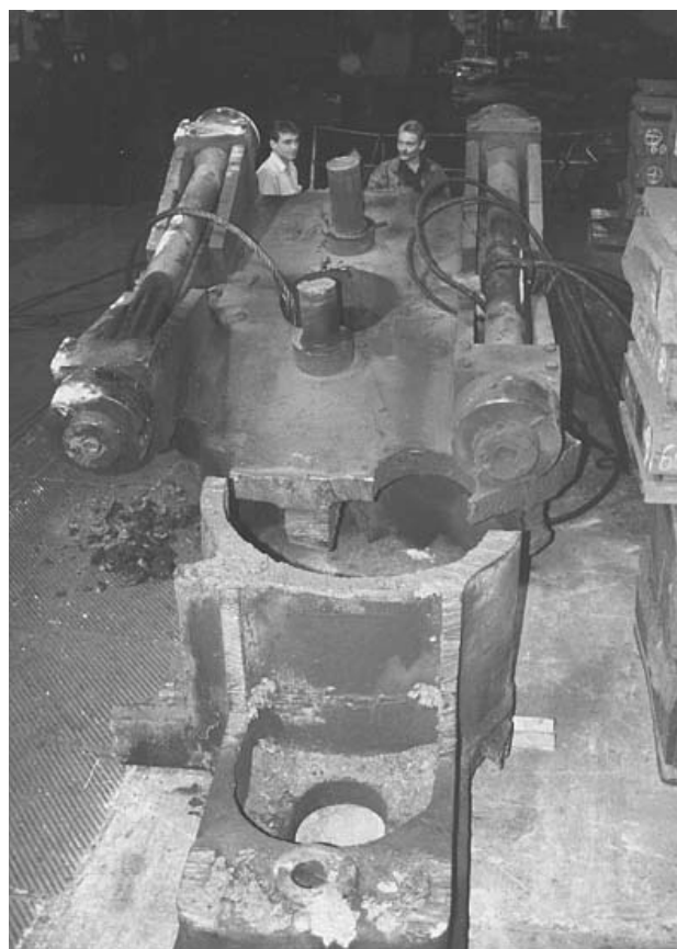
Рис. 6. Демонтаж разрушенного основания пресса максимальным усилием 100 МН с применением газовой резки. На рисунке показаны часть колонного стакана и нижняя плита основания со стяжными консолями и шпильками
